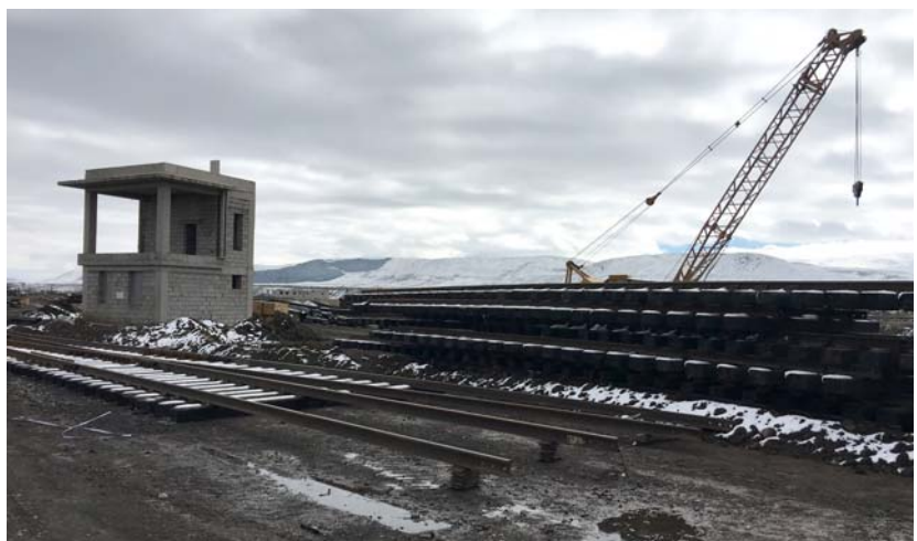
Spurwechselbahnhof Achalkalaki im Januar 2017: Die bereits seit längerer Zeit durch BVV fertig gestellte 1435/1520 mm Umspuranlage soll hier demnächst eingebaut werden. Hier soll auch einmal der Loktausch zwischen der Georgischen Elektrolok (3 kV) und Türkischen Elektrolok (25 kV 50 Hz) stattfinden.
